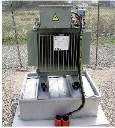
Figure 3 - Exemple de transformateur à huile et son bac de rétention (source : directindustry.fr)
